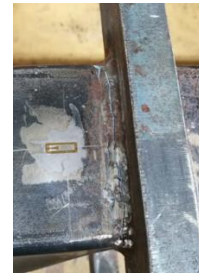
Photo4 RM4520 溶接部の亀裂の様子
